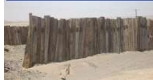
آغاز بازسازی بلاک منتظر قائم - تل حمید و انجام اقدامات اصلاحی جهت تثبیت ماسه های روان مانند تراورس کاری، کاشت نهال، احداث خاکریز و حفر کانال
